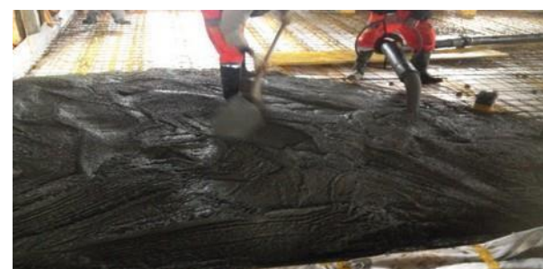
Chapes flottantes thermo-acoustiques ( 60\text{kg/m}^2 au lieu de 120\text{ kg/m}^2 ) sur supports porteurs béton à partir de D0.9 et LC2/3.
